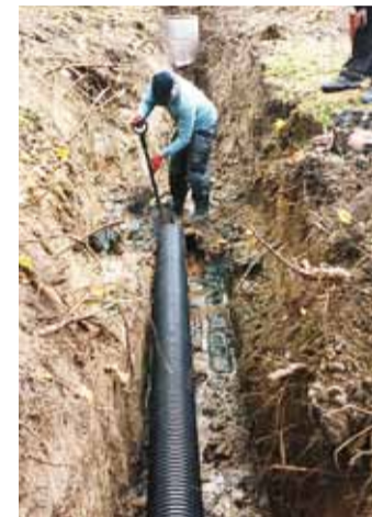
Torude pesemisel selgunud ja välja kaevatud 35 aasta vanuse purunenud sademeveetorstike asendamine – tagamaks sademevee äravoolu pargi ülemise osa kaevudest. Selliseid töid tuleb edaspidi rohkelt teha, et park kuivaks saada. Foto: Taavi Valgmäe
